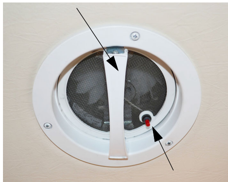
Fan Power Switch
